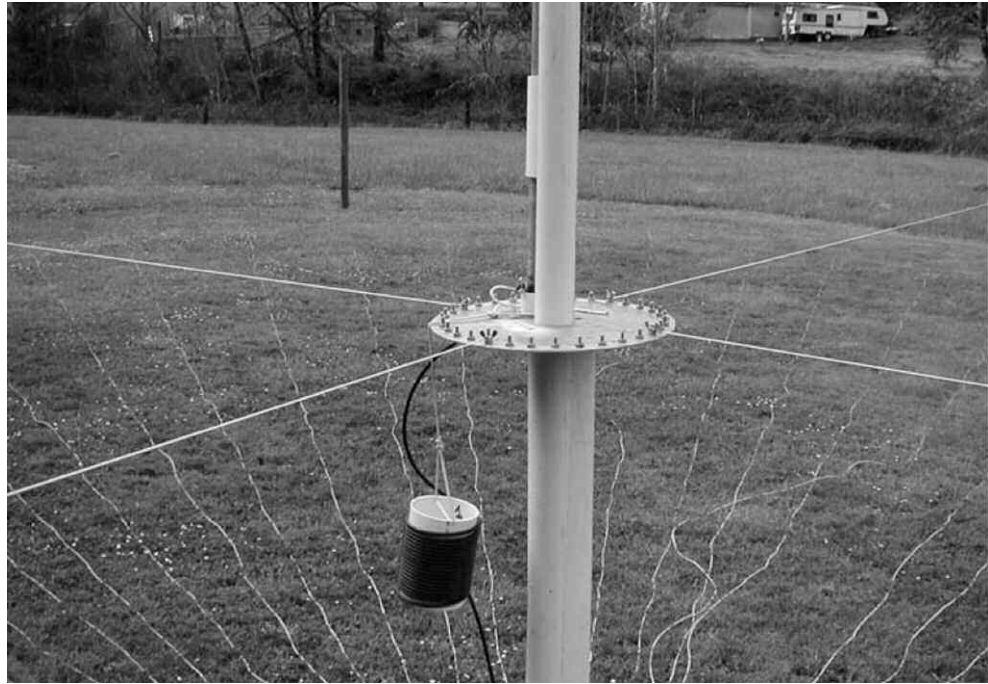
Installation des radians surélevés par rapport au sol d'une antenne verticale
