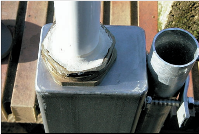
Un joint d'étanchéité recouvre le presse-étoupe du boîtier.
